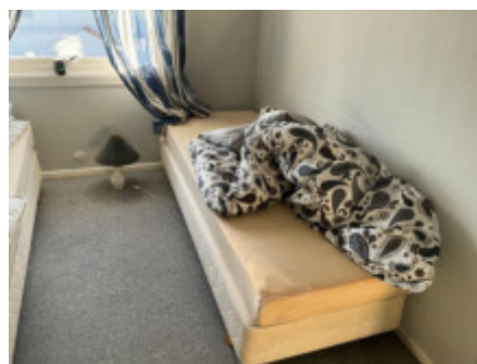
Skjevheter i etasjeskille.
