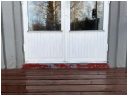
Verandadør med sprekker i treverket.
