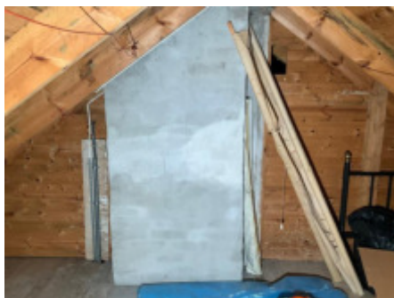
Mindre riss i pipen på loftet og i 2. etasje.
