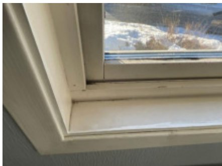
Vindu med glippe mellom karm og ramme.
