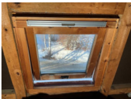
Vindu på loftet mangler håndtak.
