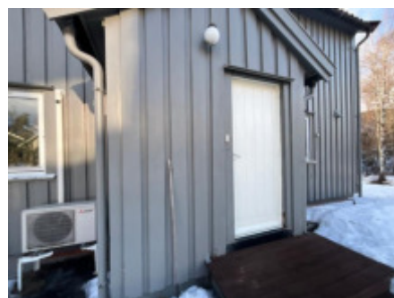
Ytterdør med utettheter mellom karm og ramme.
