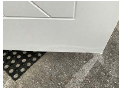
Fuktskader i bunnen av døren.
