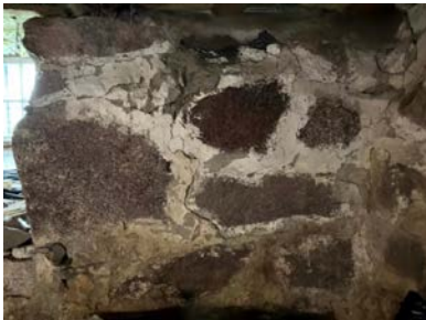
Sprekker i grunnmur.
