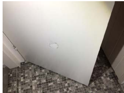
skader/hull i vaskeroms dør
