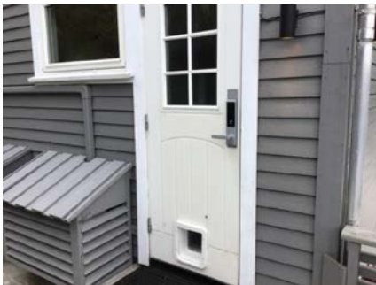
Dør fra vaskerom med fuktskader i dørblad
