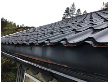
rust i nedkant og i skjøter
