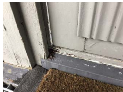
råte skade i dørkarm
