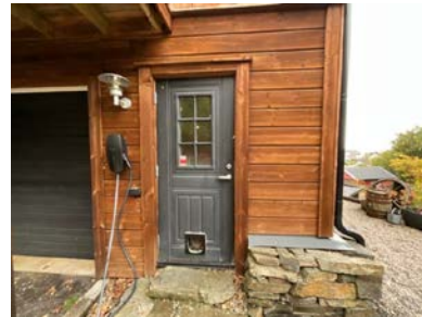
Eldre dør med skader.
