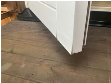
Liten fuktskade i bunnen av døra.
