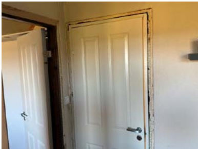
Manglende karmlister rundt dør.
