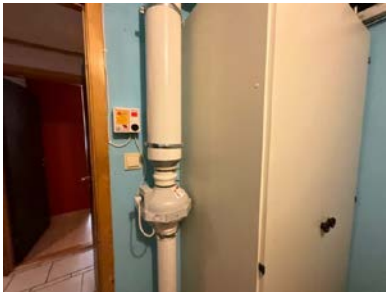
Avsug i underetasjen.
