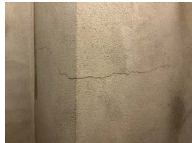
Riss i pipevangen, bør undersøkes nærmere.
