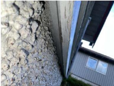
Eldre deler av bygget har ikke lufting etter dagens krav.
